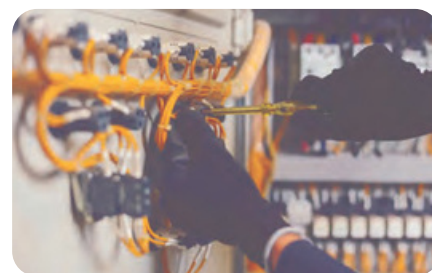
NR 10 Seg. em Inst. e Serviços com Eletricidade Básico - Iniciação
